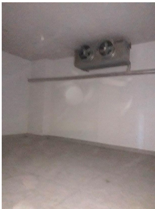
Figura 30: Câmara de Espera do Entrepasto TPP/Cabedelo Foto: Pier 3 (2019)
