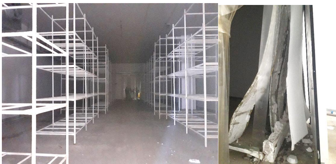
Figura 32: Câmara de congelados, detalhe da porta destruída. Foto: Pier 3 (2019)
