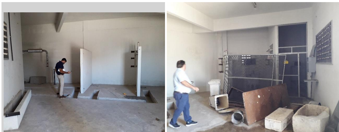
Figura 40: Fotos da Subestação Fotos: Pier 3 (2019)
