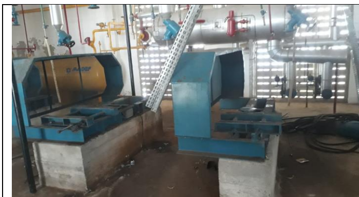
001 – SALA DE MÁQUINAS
