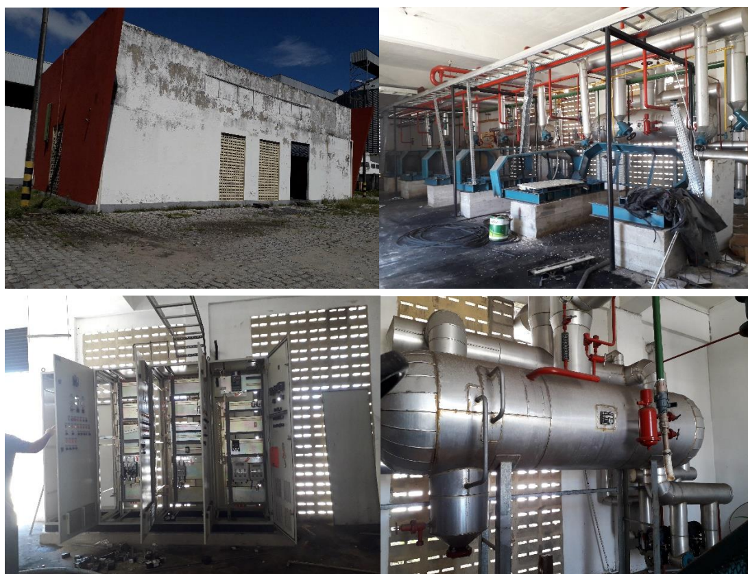
Figura 40: Fotos Casa de Máquinas Fotos: Pier 3 (2019)
