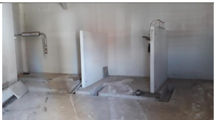
002 – SUBSTAÇÃO DE ENERGIA
