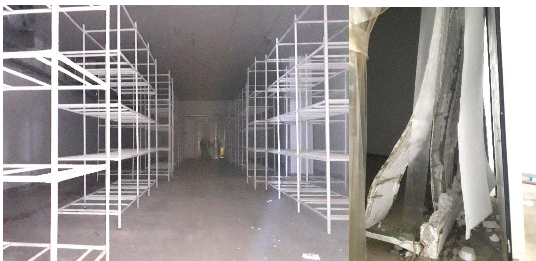
Figura 33: Câmara de congelados, detalhe da porta destruída. Foto: Pier 3 (2019)
