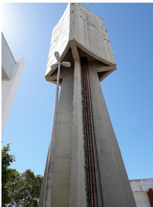
Figura 42: Reservatório de água Fotos: Píer 3 (2019)
