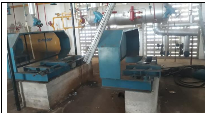
001 – SALA DE MÁQUINAS
