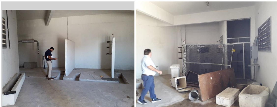
Figura 41: Fotos da Subestação Fotos: Píer 3 (2019)
