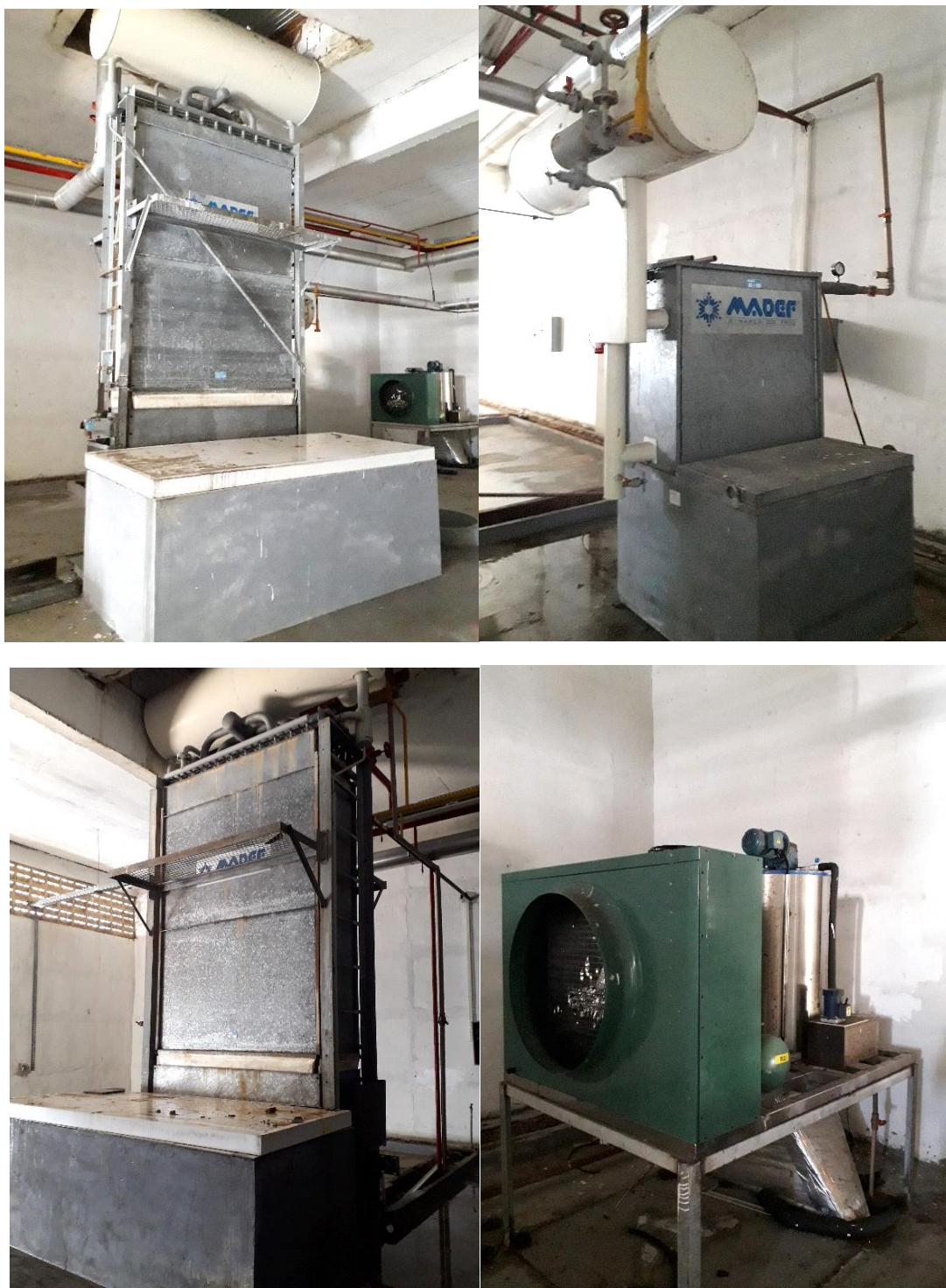
Figura 36: Fotos dos geradores de gelo Fotos: Pier 3 (2019)
