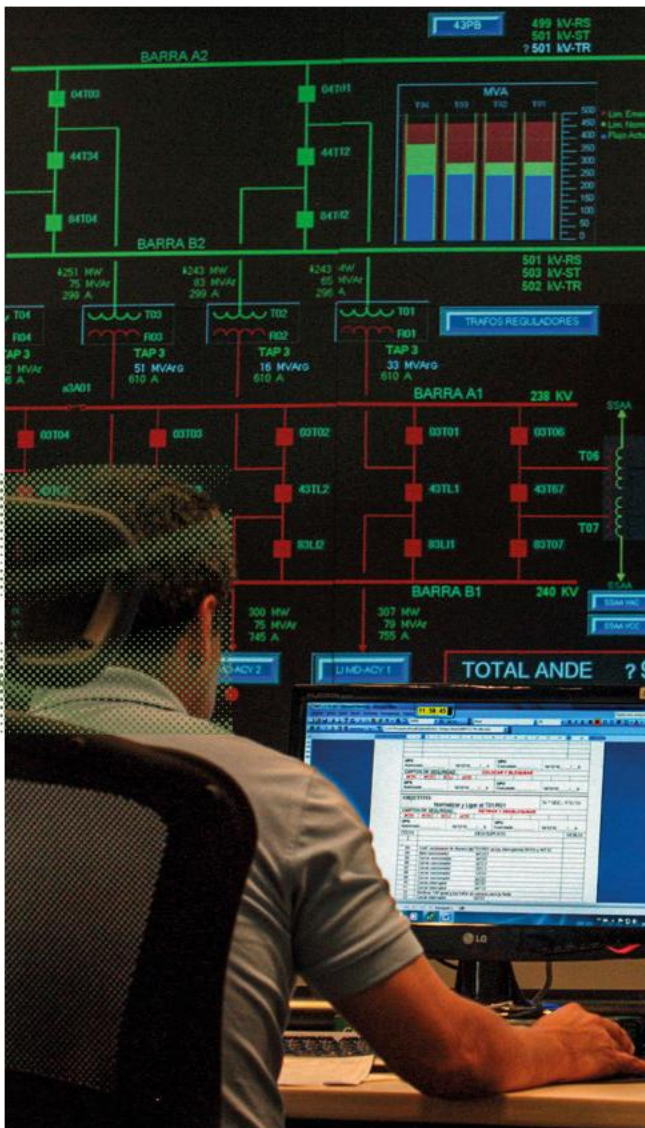
Sala de controle de distribuição de energia elétrica da hidrelétrica de Itaipu Binacional em Foz do Iguaçu (PR) | Foto: Joédson Alves (Agência Brasil)
