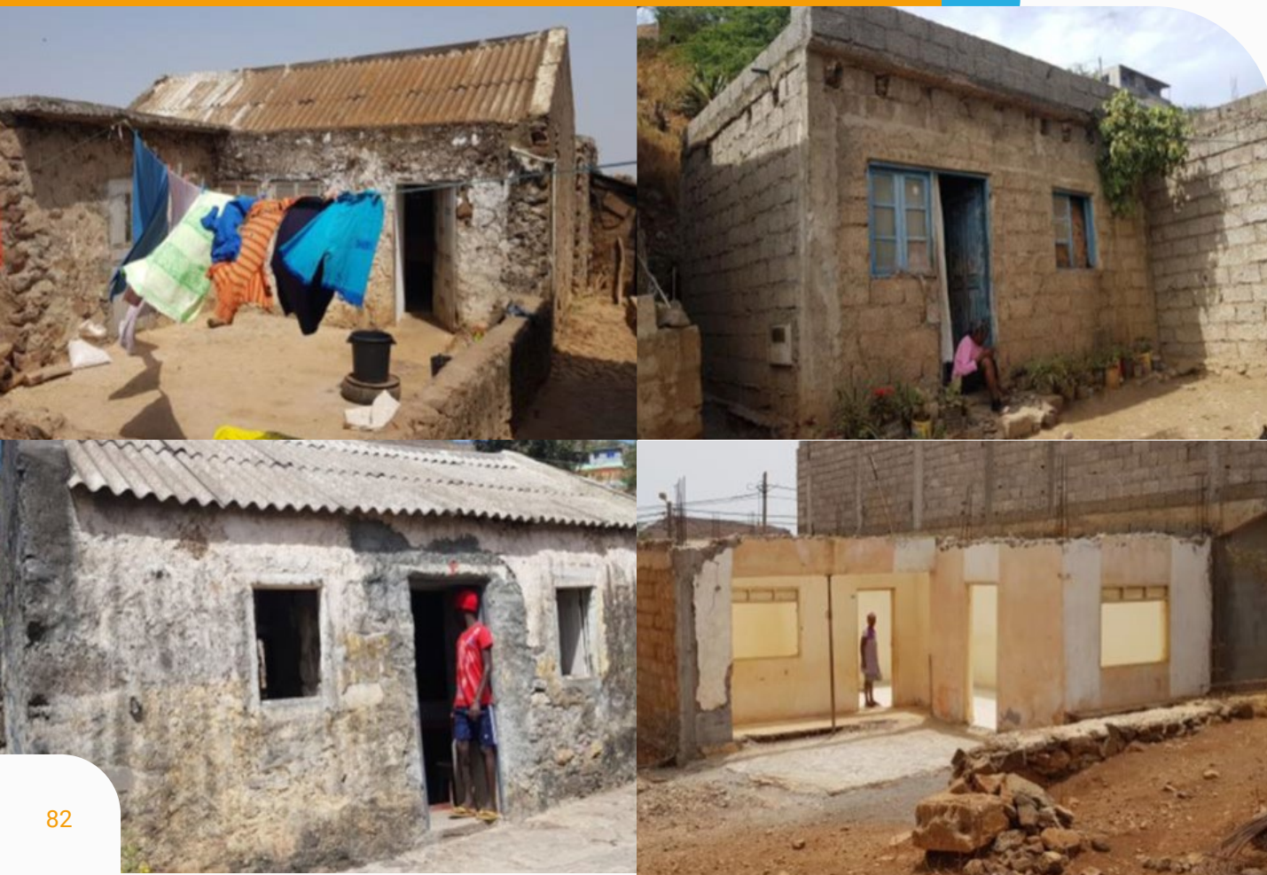
Figura 25: Moradias de famílias beneficiárias para projetos de habitação social em São Domingos, com necessidades de reparos comuns a outros territórios de Cabo Verde
